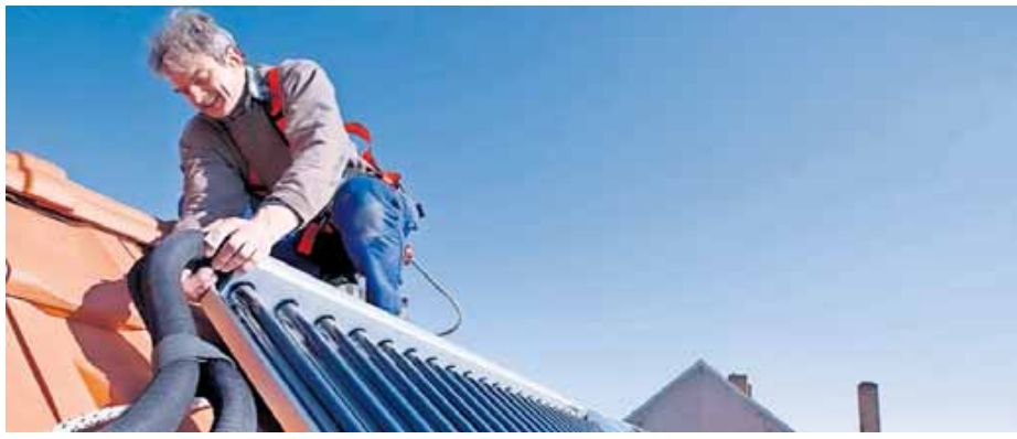
Solarthermische Anlagen lohnen sich auch in unseren Breitengraden, selbst in frostigen Zeiten. FOTO: TOM PISCHELL/BDH
